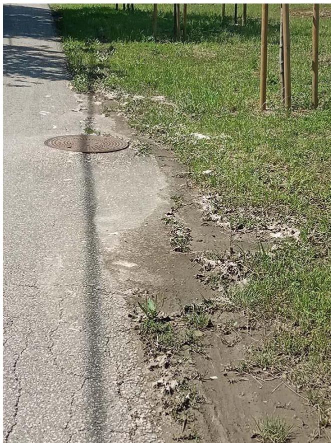
3. kép: Csapadékhullás után az illegális csapadékvíz-rákötések miatt kiöntött szennyvíz nyomai; Tápé, Rába u. (fotó: Korom A. 2021)
