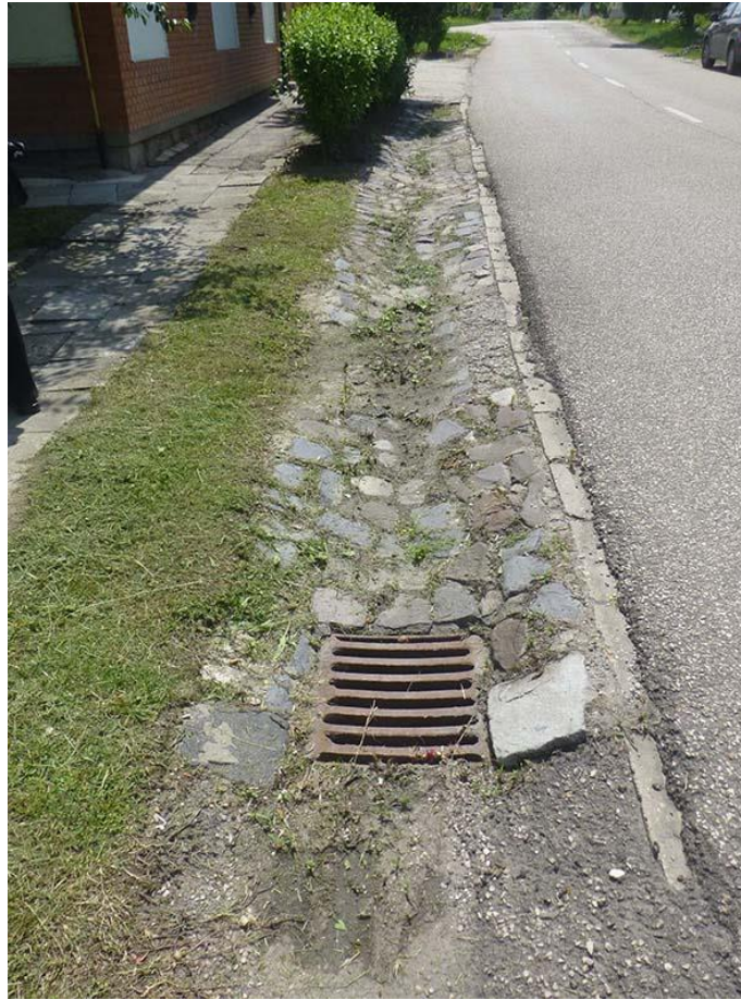
13. kép: Kőkirakású folyóka, alatta zárt csapadék csatorna (mintaszerű megoldás); Tápe, Veres P. utca (fotó: Korom A. 2021)
